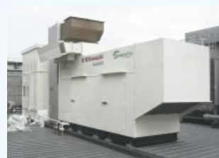
非常用発電機
