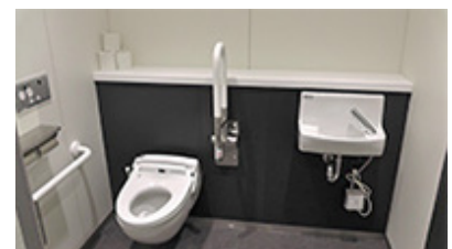
車いすの方も使用しやすいトイレ（群馬製作所・西本館）
