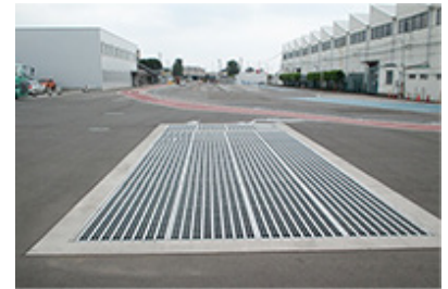
浸水対策（排水口） (宇都宮製作所)
